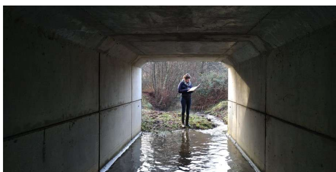
Les ponts, buses, dalots et ponceaux peuvent jouer un rôle majeur dans la transparence écologique du réseau primaire s'ils possèdent des caractéristiques adaptées.
